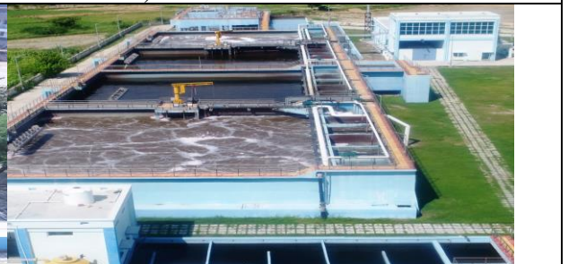
24 MLD STP, Etah
